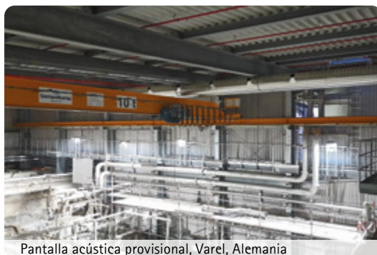
Pantalla acústica provisional, Varel, Alemania
